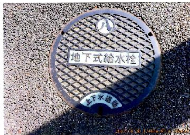
地下式給水栓(南門前東側)
