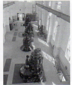
松重ポンプ所の内部
